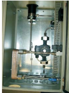
... Nassteil der Oxytherm-Anlage
