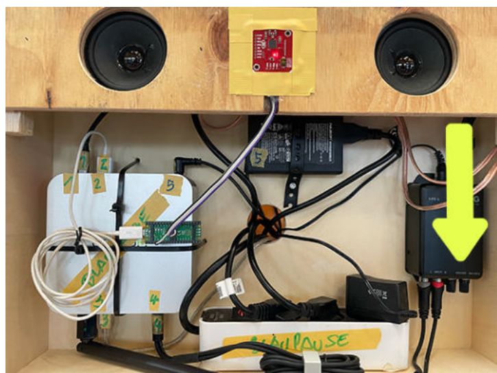
Von links n. rechts: Mini-PC, Mehrfachsteckdose, Netzteil Screen, Verstärker Lautsprecher, Oben: Lautsprecher, RFID-Reader
