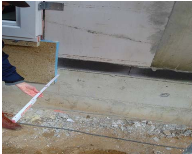
20 cm Außenwandwärmemedämmung – typisch für ein Passivhaus 20 cm of exterior building shell insulation – typical for a passive house
