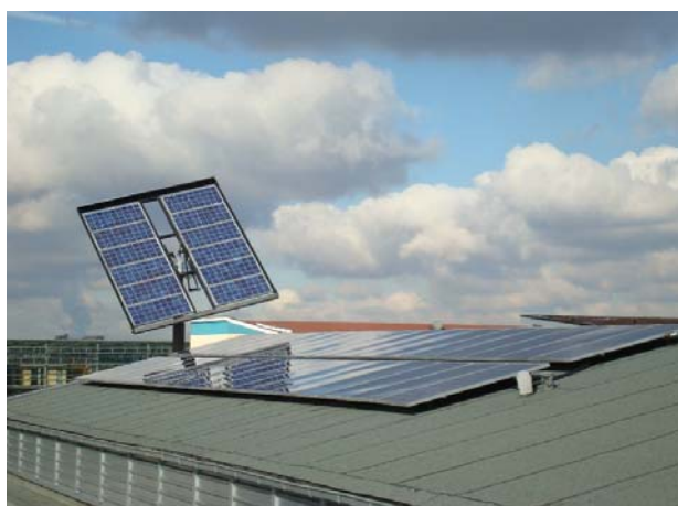
Solaranlage auf dem Dach des BHKW Solar panels on the roof of the CHP
