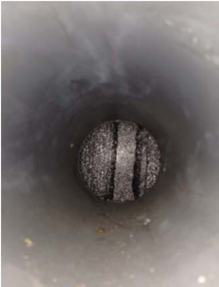
Abb. 35: Verbindungsstück zwischen Wohnzimmer im OG und Fassadenkanal
