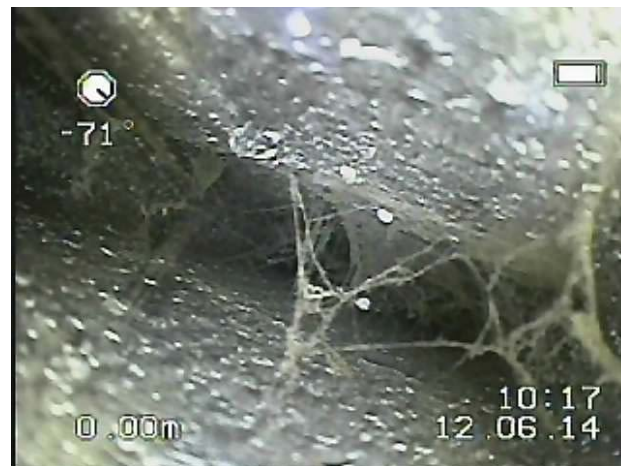
Abb. 38: Vertikaler Lüftungskanal in der oberen Küche
