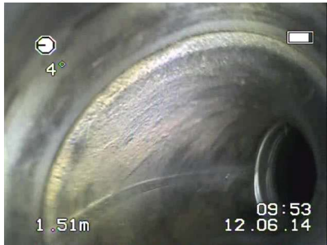
Abb. 34: 90°-Umlenkung im zentralen Abluftkanal mit Staubablagerungen
