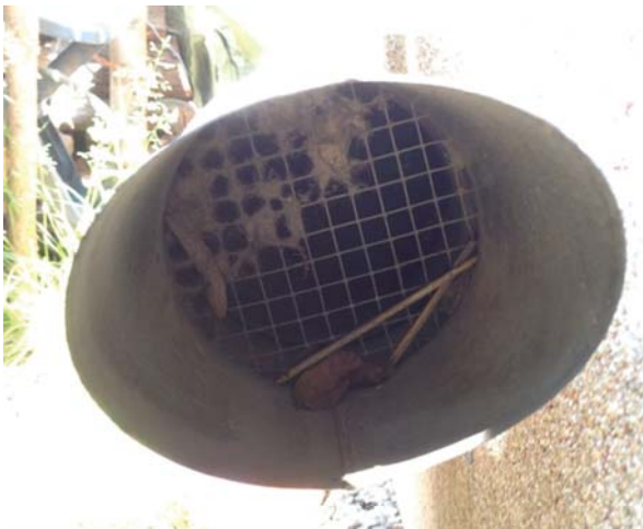
Abb. 33: Außenluftansaugung mit Lüftungsgitter
