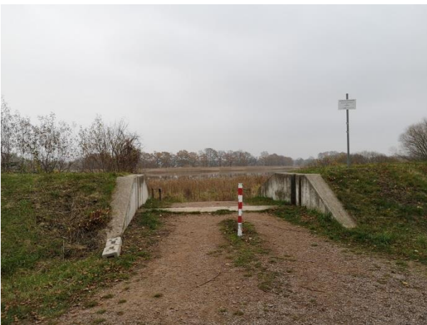
Abb. 54 Kühnauer Park, Deichquerung Nähe der Kirche in der Burgkühnauer Straße, Ausführung mit wassergebundener Decke, Vegetation führt in nicht befahrenen Bereichen, in Randbereichen und in der Mitte zur Verkräutung (Zötzl, 2021)
