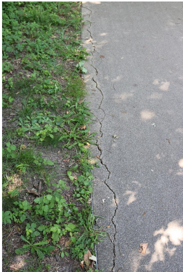
Abb. 172 Rissbildungen in der epoxidharzgebundenen Wegedecke an der mit Bandeisen gefassten Wegekante (Sommer 2022) (Benecken, 2022)
