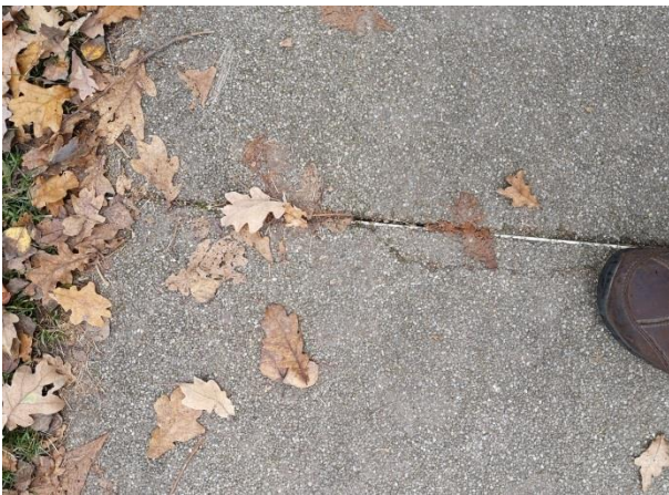
Abb. 79 Ausbruch im Bereich der Trennfuge (Zötzl, 2021)
