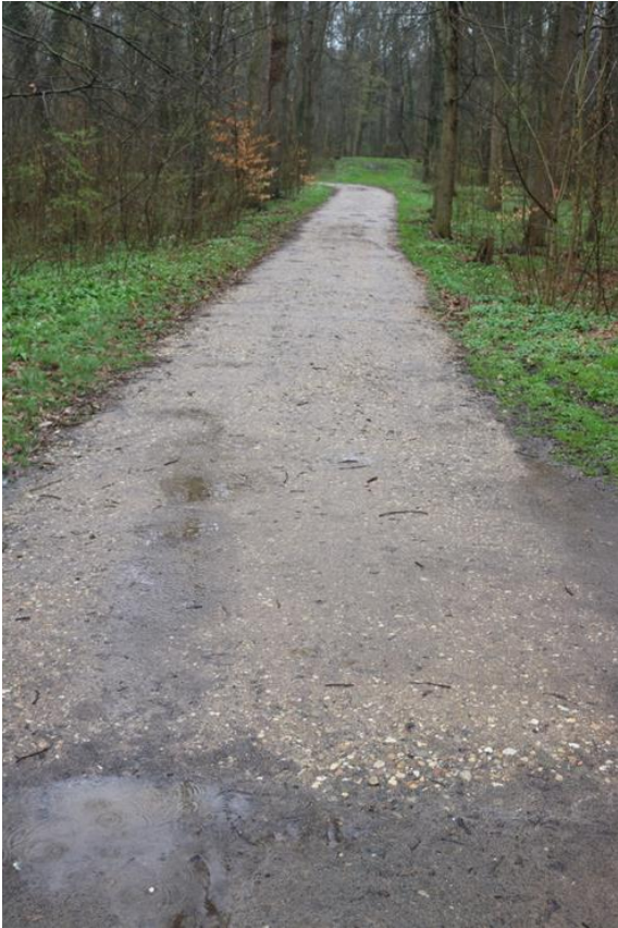
Abb. 179 Weg mit Wandkiesdecke, vorn unsanierterer Wegebereich (Benecken, 2023)
