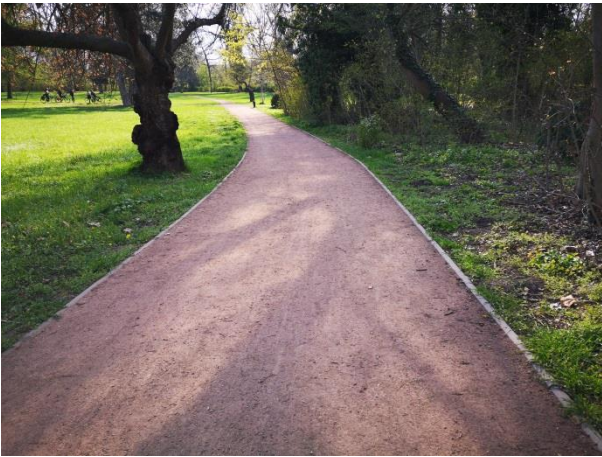
Abb. 31 Halle, Gimritzer Park, wassergebundene Deckschicht. Betonsteineinfassung zeigt im Kantenbereich, mit dem Gefälle Auswaschungen (rechts) und einen Materialeintrag in die Vegetationsfläche über die Kante, links. (Zötzl, 2021)
