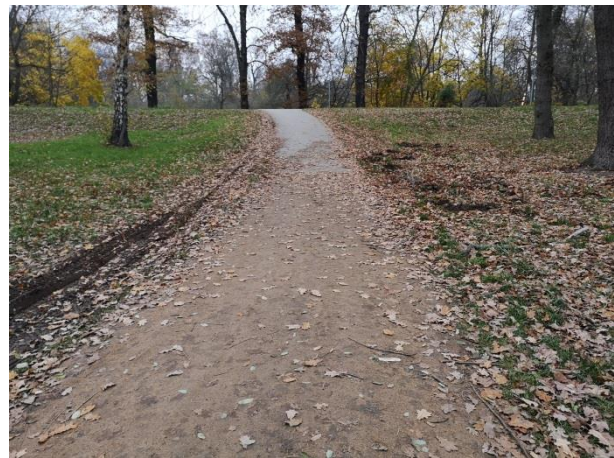
Abb. 80 Bereich der wassergebundenen Decke mit Spurrinnen und anschließender Pfützenbildung (Zötzl, 2021)
