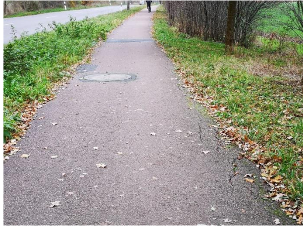
Abb. 84 Fußgänger- und Radweg gegenüber Löwentor mit einer Asphaltdecke zeigt in den Randbereichen Rissbildung durch Absenkung (Zötzl, 2021)
