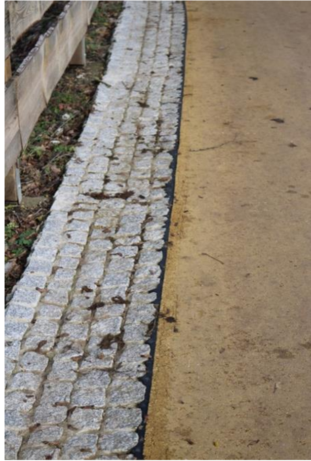
Abb. 127 wie Abb.126, Detail, Übergang zwischen Gussasphalt und Gerinne (gebundene Bauweise) (Benecken, 2023)
