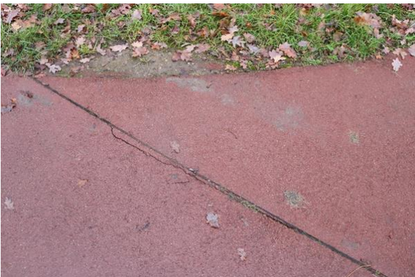
Abb. 123 Asphaltdeckschicht, Anschlussfuge (Benecken, 2022)
