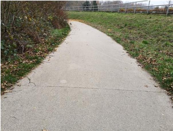
Abb. 60 Steigungsbereich in LUWADUR, Schäden im Außenbereich beider Seiten, an der Trennfuge (Zötzl, 2021)
