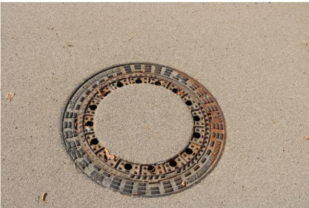
Abb. 177 kleinflächig aufgebrachte epoxidharzgebundene Deckschicht auf Kanaldeckel (Benecken, 2022)
