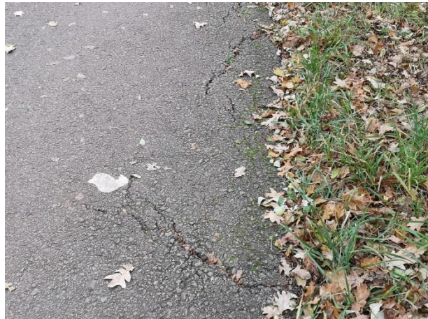
Abb. 86 Fußgänger- und Radweg gegenüber Löwentor mit einer Asphaltdecke zeigt in den Randbereichen Rissbildung durch Absenkung (Zötzl, 2021)
