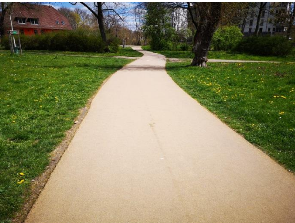
Abb. 5 Magdeburg, Klosterbergegarten, farbige Asphaltdecke. ungenaue Randführung bei der Herstellung (Zötzl, 2021)
