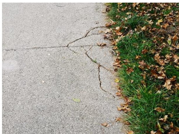
Abb. 63 Steigungsbereich in LUWADUR, Schäden im Außenbereich beider Seiten, an der Trennfuge (Zötzl, 2021)
