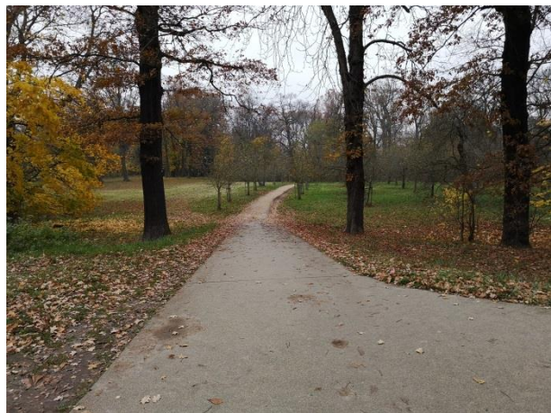
Abb. 76 Im Steigungsbereichen eingesetzte LUWADUR-Decke mit Übergang zur wassergebundenen Decke, Verschmutzungen (Zötzl, 2021)
