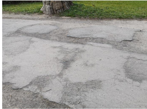
Abb. 50 Leipzig, Johannapark, Asphaltweg parallel Karl-Tauchnitz-Straße, Nähe Herzliya-Platz, Übergangsbereich zur wassergebundenen Deckschicht: Große schollenartige Ablösungen der Oberflächen der asphaltgebundenen Deckschicht (Zötzl, 2021)
