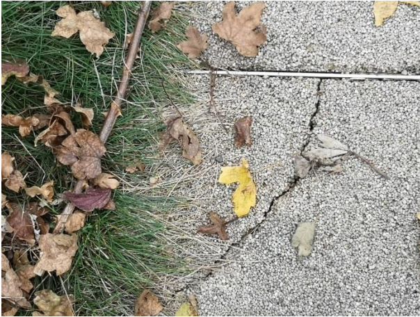
Abb. 64 Steigungsbereich in LUWADUR, Schäden im Außenbereich beider Seiten, an der Trennfuge (Zötzl, 2021)
