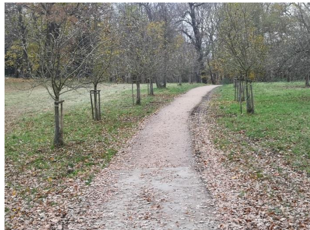
Abb. 82 Spurrinnen im Übergangsbereich zwischen epoxidharz- und wassergebundener Decke zeigen eine Nutzung durch zu breite und zu schwere Fahrzeuge (Zötzl, 2021)
