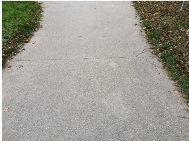
Abb. 61 Steigungsbereich in LUWADUR, Schäden im Außenbereich beider Seiten, an der Trennfuge, helle Flecken vermutlich durch Reinigungsmittel (Zötzl, 2021)
