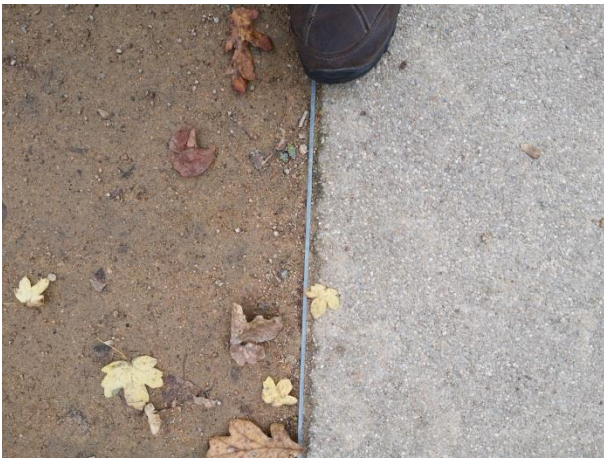
Abb. 70 Übergang von der epoxidharzgebundenen Decke zur wassergebundenen Decke, entlang der Metallkante kommt es zur Befeuchtung und zu ersten Ausbrüchen im Bereich der Epoxidharzdecke (Zötzl, 2021)
