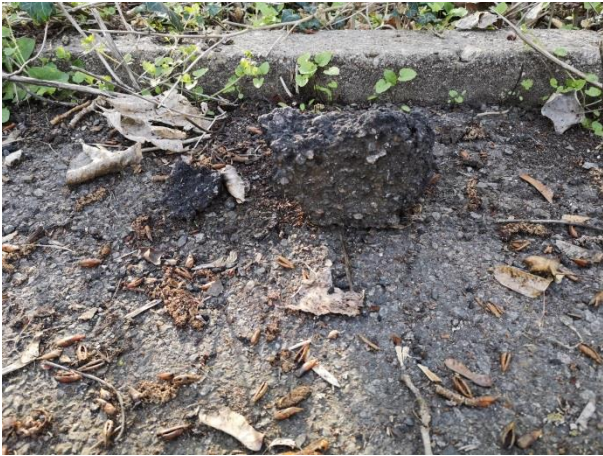
Abb. 23 Halle, Peißnitzinsel, asphaltierter Nebenweg parallel zur Saale, Humusauflage, ausgebrochener Teil der Decke (Zötzl, 2021)
