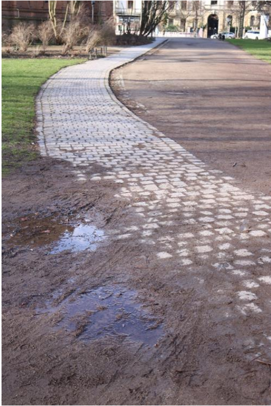
Abb. 153 Übergang hist. Kupferschlackebahn zu wassergebundenem Wegebelaag, Zustand unmittelbar nach Frost-Tau-Wechsel (Februar 2023) (Benecken, 2023)
