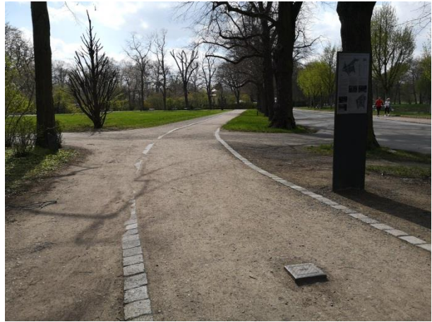
Abb. 44 Leipzig, Clara-Zetkin-Park, Weg parallel zur Anton-Bruckner-Allee, wassergebundene Deckschicht, Wegeingrenzung durch Schlackesteine, Ausspülung über die Begrenzung, Stolpergefahr (Zötzl, 2021)
