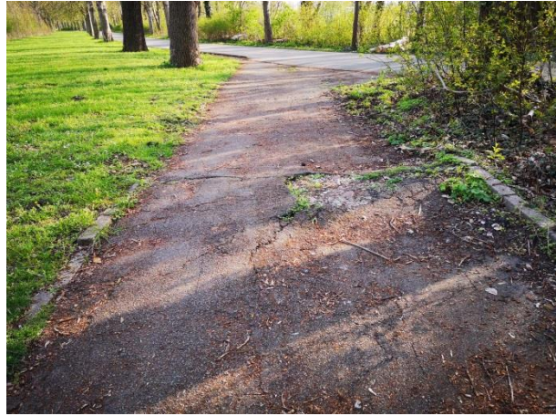
Abb. 22 Halle, Peißnitzinsel, asphaltierter Nebenweg parallel zur Saale, Humusauflage, Rissbildung durch Absenkung, Aufwölbung durch Wurzeldruck, Ausbruch, Verkrautung (Zötzl, 2021)
