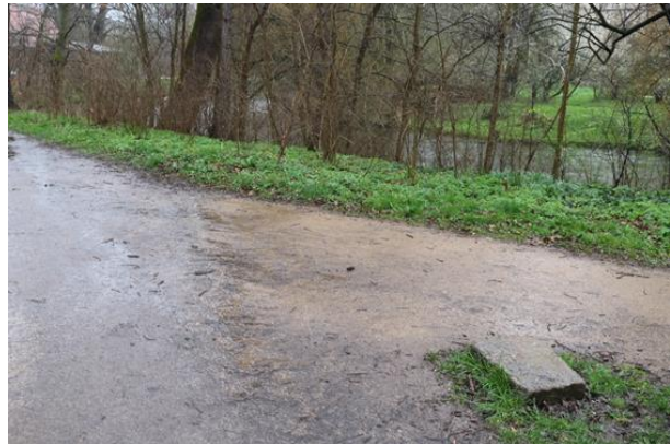
Abb. 186 Sanierter Wegeanschluss (wassergebundene Decke) nach Regenereignis (Benecken, 2023)
