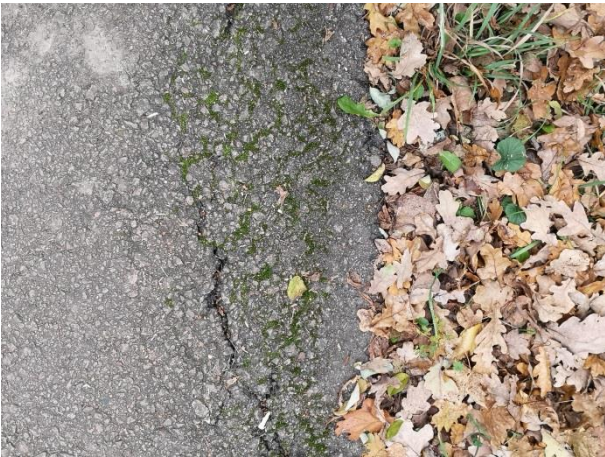
Abb. 85 Fußgänger- und Radweg gegenüber Löwentor mit einer Asphaltdecke zeigt in den Randbereichen Rissbildung durch Absenkung (Zötzl, 2021)
