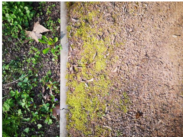
Abb. 28 Halle, Gimritzer Park, wassergebundene Deckschicht. Die Betonsteineinfassung behindert den Abfluss von Niederschlagswasser, was zu einer Vergrünung, links im Bild, führt. (Zötzl, 2021)
