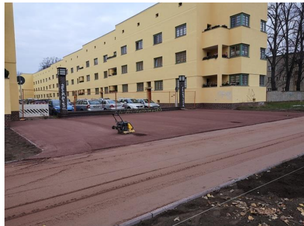
Abb. 98 Magdeburg, Pappelallee, Im Vordergrund sichtbar ist die dynamische Schicht. Oberhalb wurde die Deckschicht bereits aufgetragen (Zötzl, 2020)
