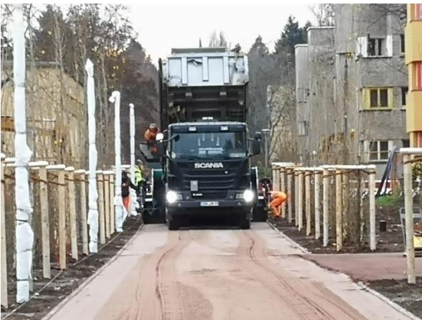
Abb. 97 Magdeburg, Pappelallee, Einbau der Deck-schicht. Im Vordergrund sichtbar ist die dy-namische Schicht. Rechts im Bild, im Bereich des Seitenwegs, wurde die Deckschicht bereits aufgetragen. (Zötzl, 2020)
