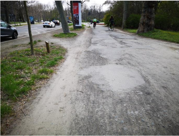
Abb. 49 Leipzig, Johannapark, Asphaltweg parallel Karl-Tauchnitz-Straße, Nähe Herzliya-Platz, geschädigte asphaltgebundene Deckschicht (Zötzl, 2021)
