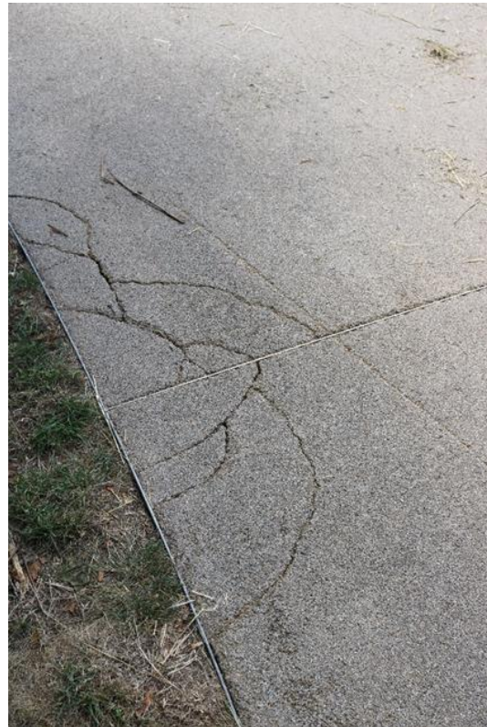
Abb. 158 wie Abb. 157, Detail, Wegekante und Fuge, Schäden (Sommer 2022) (Benecken, 2022)
