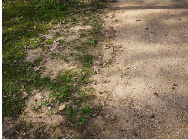
Abb. 42 Leipzig, Clara-Zetkin-Park, Blickrichtung Glas-haus, wassergebundene Deckschicht, nicht zur Vegetationsfläche begrenzt. Daher schneller Übergriff der Vegetation auf die Wegefläche (Zötzl, 2021)
