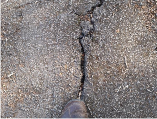
Abb. 21 Halle, Peißnitzinsel, asphaltierter Nebenweg parallel zur Saale, Rissbildung durch Absenkung (Zötzl, 2021)
