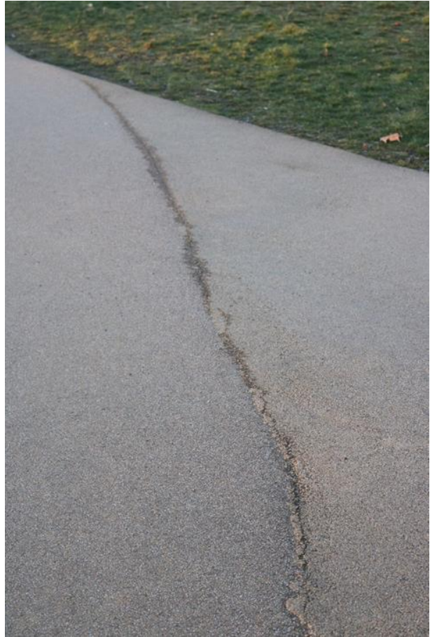
Abb. 112 Fuge zwischen zwei benachbarten asphaltbefestigten Wegeabschnitten mit leicht abweichender Farbgebung (Benecken, 2023)
