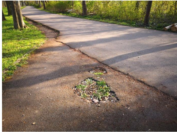
Abb. 24 Halle, Peißnitzinsel, asphaltierter Nebenweg parallel zur Saale, Ausbruch, Verkrautung (Zötzl, 2021)
