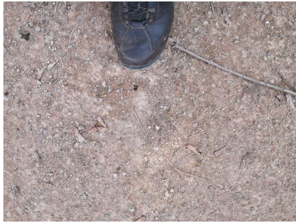
Abb. 32 Halle, Gimritzer Park, wassergebundene Deckschicht, Humusauflage. Frostlochbildung im Bereich abtropfender Bäume (Zötzl, 2021)
