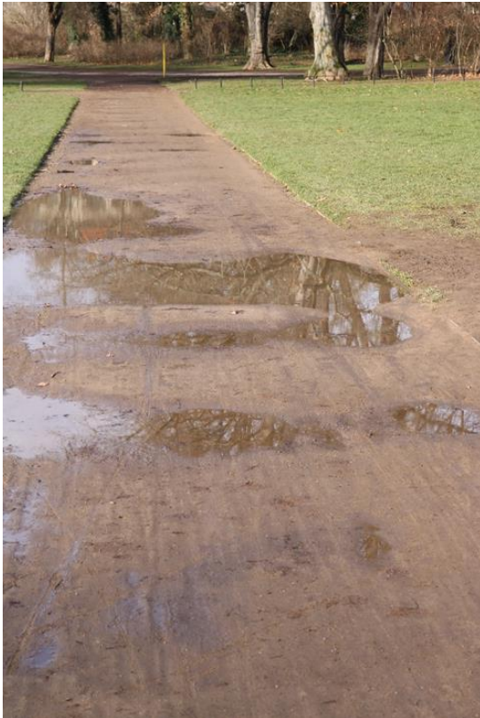
Abb. 151 Zustand unsanierte, stark frequentierte Fahrradverkehrsverbindung unmittelbar nach Frost-Tau-Wechsel (Februar 2023) (Benecken, 2023)
