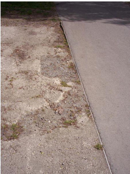
Abb. 53 Leipzig, Lene-Voigt-Park, geschädigte EP-gebundene Deckschicht neben einer asphaltgebundenen Deckschicht (Benecken, 2016)
