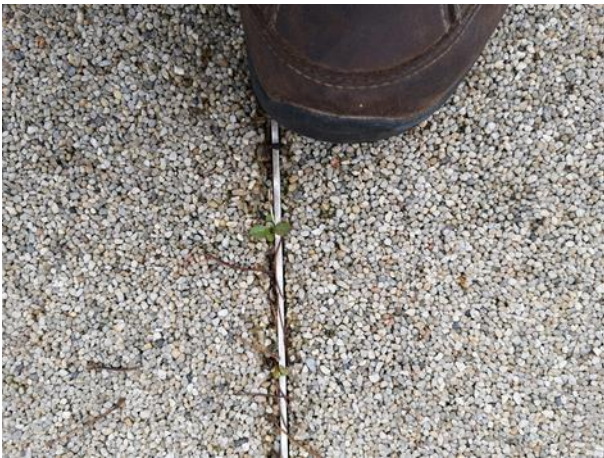
Abb. 66 Erste Ausbrücke und erste Begrünungen im Bereich der Metallschiene zwischen den einzelnen Abschnitten (Zötzl, 2021)
