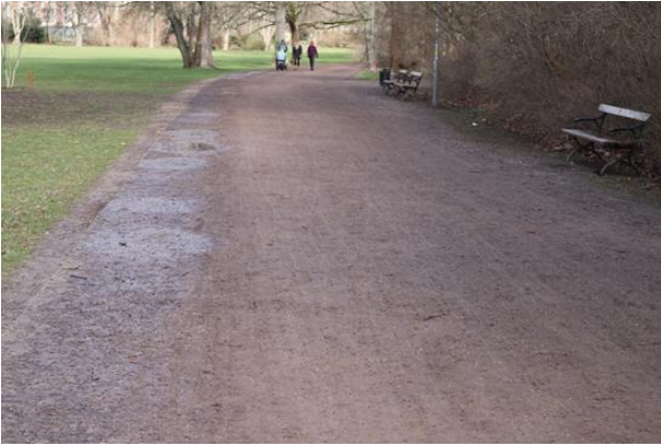
Abb. 149 Zustand sanierter Hauptwegeabschnitt unmittelbar nach Frost-Tau-Wechsel (Februar 2023) (Benecken, 2023)
