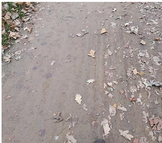
Abb. 72 Bereich der wassergebundenen Decke mit Spurrinnen und anschließender Pfützenbildung (Zötzl, 2021)
