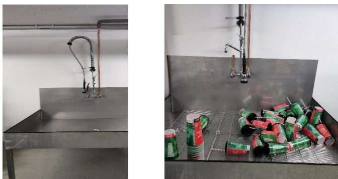
Abbildung 9 Edelstahlwanne an der Rückgabestation
