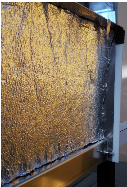
Abbildung 39: Schalldämpfer (Zuluftseite) mit Absorptionsmaterial
