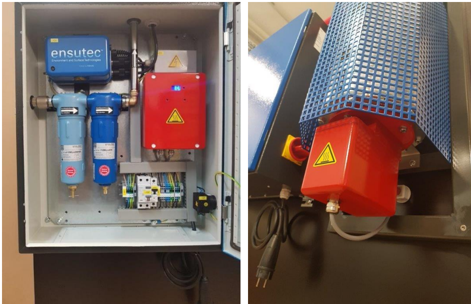
Abbildung 19: Detailansicht des Heizsystems nach Überarbeitung: Steuerung mit 35 °C Zieltemperatur, der Hochspannungseinheit nachgeschaltetes Heizsystem
