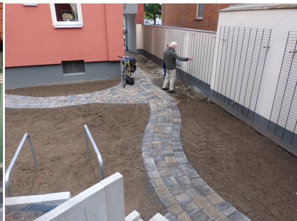
Foto 12: Beratung durch den BUND im Zuge einer Hofensiegelung in Kombination mit einer Begrünung durch Gerüstkletterpflanzen (BUND Region Hannover).
