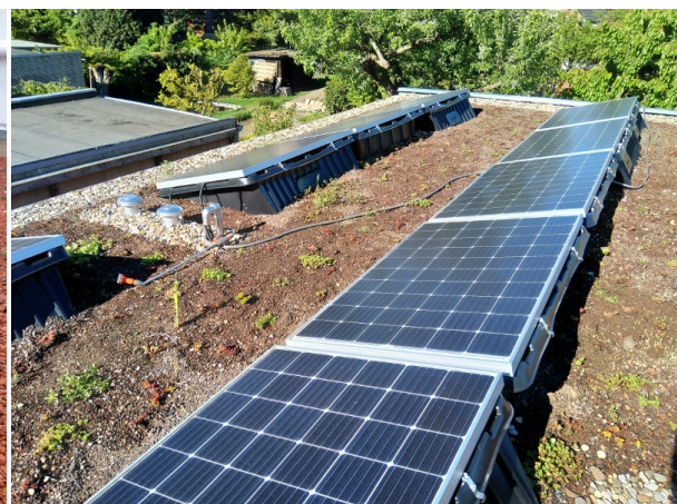
Foto 14: Extensiv angelegte Gründach in Kombination mit Solar-Modulen (Jonas Henatsch).
