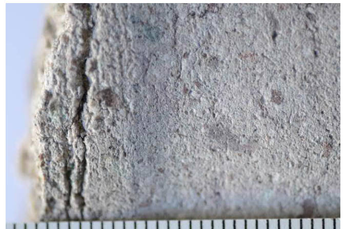
Abbildung 35: Wandungsfläche des Bohrkernes BR/K/16 im unmittelbaren Oberflächenbereich (links). Deutlich sichtbar ist die Gefügeschwächung in der oberflächennahen Zone, die sich in einer Rissbildung äußert.
