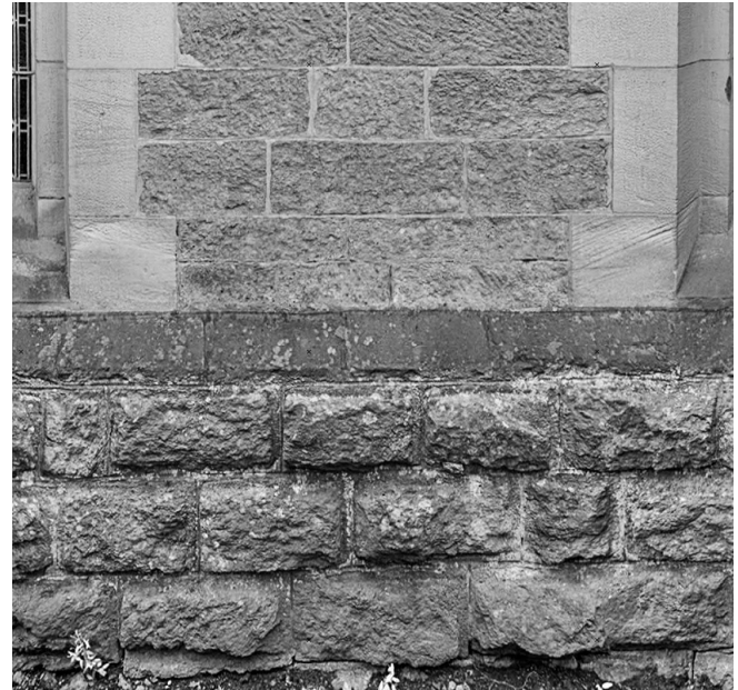
Abbildung 145: Testfläche D an der Nordfassade vor Beginn der Bearbeitung
