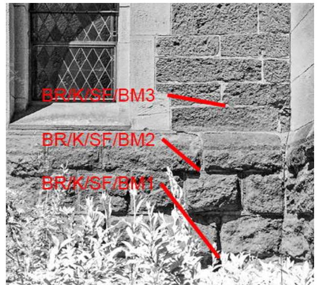
Abbildung 108: Probenahmestellen an der Südfassade (Ausschnitt Messbild Planungsbüro für Steinrestaurierung in der Denkmalpflege)
