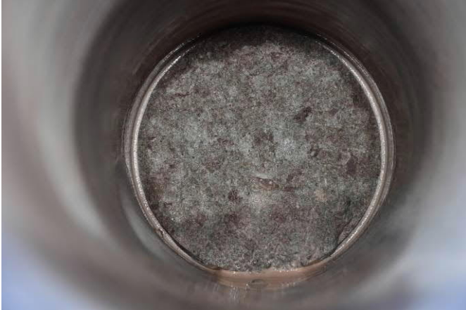
Abbildung 17: Bohrlochstirn der Bohrung BR/K/13 mit Abbruchfläche des Bohrkernes in 29 cm Tiefe
