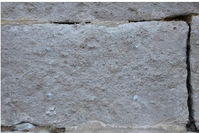
Abbildung 184: Messfläche 1 vor der Reinigung (violettgraue Variation, stark abgriesende Oberflächen)
