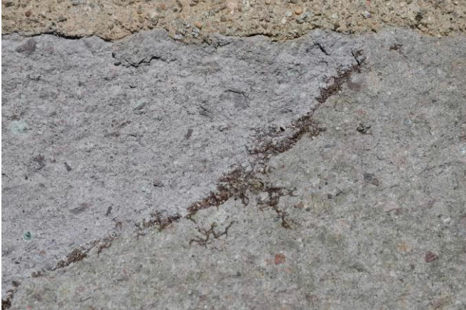
Abbildung 154: Detail der randseitigen Injektage der Oberflächenschale: Das unverdünnte Epoxidharz ist in das angrenzende Riss- und Spaltensystem der Schale migriert.
