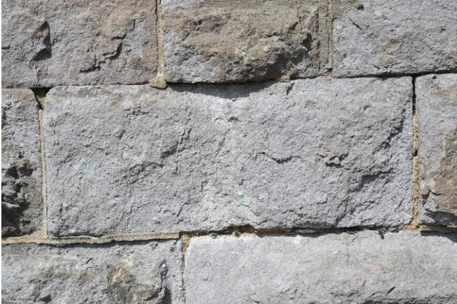
Abbildung 163: Werkstück des Sockels mit bereits abgewitterter Bossierung (Testfläche A) vor dem Schlämmenauftrag
