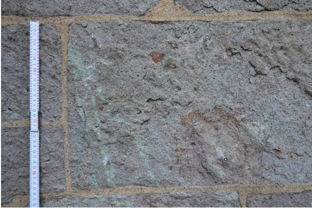
Abbildung 192: Messfläche 5 vor der Reinigung (violettgraue Variation, Oberfläche mit starker Rückwitterung und Schalenbildung)
