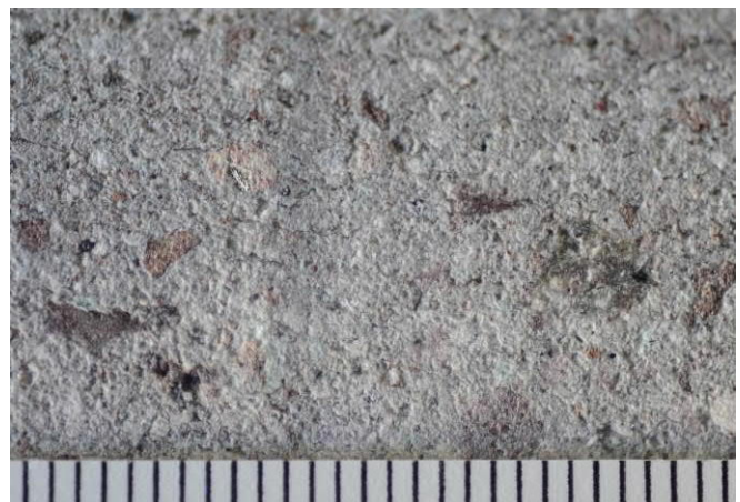
Abbildung 32: Offenbar ungeschädigte Wandungsfläche des Bohrkernes BR/K/11 aus dem inneren Bereich
