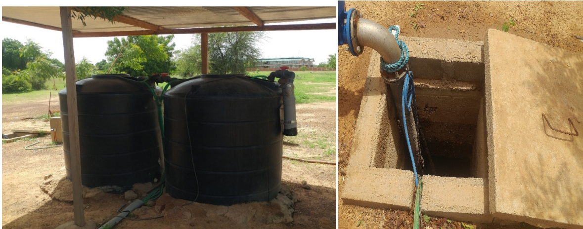
Abbildung 6: Versuchsaufbau, Links: BioTopp-System; Rechts: Schacht des Speichertanks für das vorbehandelte Abwasser
