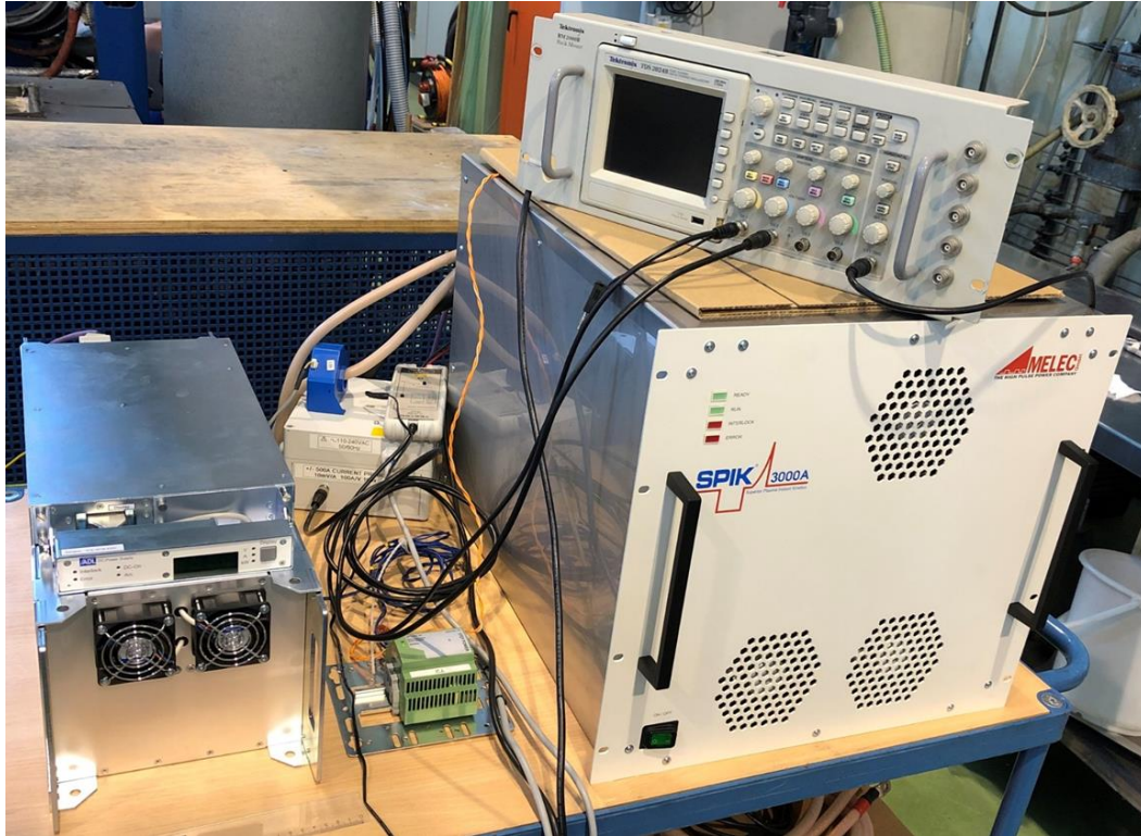
Bild 3-28: Installation Pulser SPIK3000A, DC-Teil
