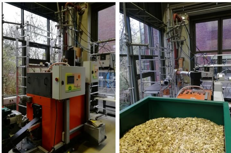
Abbildung 2.9: Verbrennungsmessstand des Instituts für Umwelttechnik und Energiewirtschaft (IUE) der Technischen Universität Hamburg (TUHH) mit einer Hackschnitzelfeuerungsanlage (links) und einem Brennstoffbunker (rechts) der Firma Heizomat.
