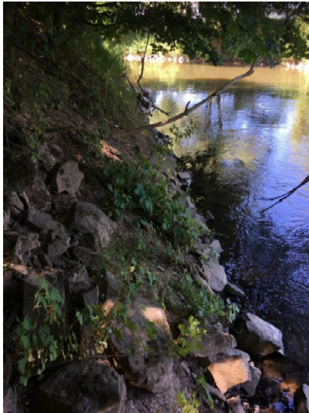
Abbildung 12: Ufersicherungen durch Steine an der Blies im Projektgebiet nahe der Einmündung des Hainbachs (Foto: I. Juszczuk).
