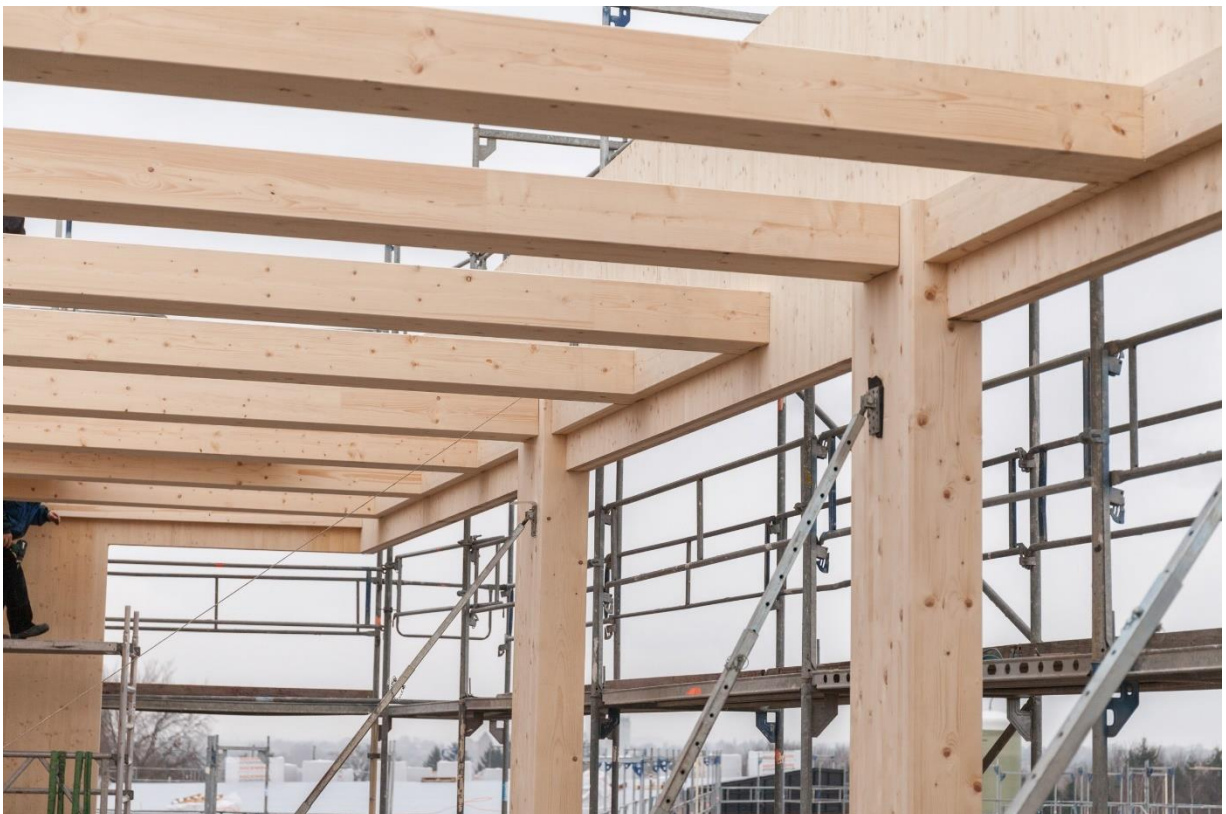
Abbildung 2-40 Fassadentragwerk – Stützen mit tragender Brüstung aus BSP und den Auflagern der HBV-Decke
