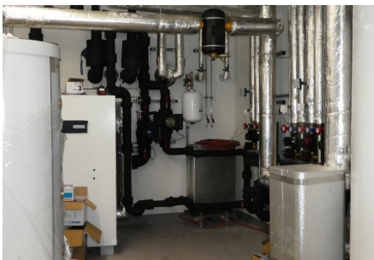
Abbildung 5-2 Foto Technikraum (TARA Ingenieurbüro GmbH & Co. KG).
