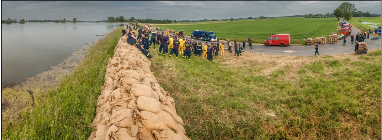
Abb. 32: Aufkragungen aus Sandsäcken am Elbedeich bei Hitzacker im Juni 2013 (Foto: Bärbel Koppe)
