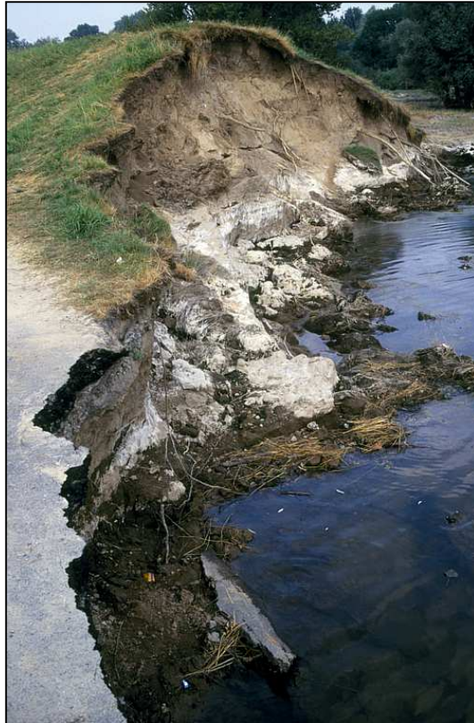
Abb. 30: Deichbruch bei Aurith, Ziltendorfer Niederung während des Oderhochwassers 1997 (Foto: Manfred W. Jürgens)
