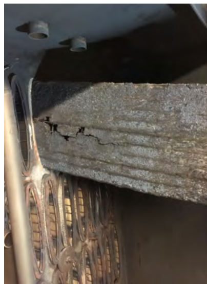
Bild 47: Einer von mehreren defekten Filterschläuchen
