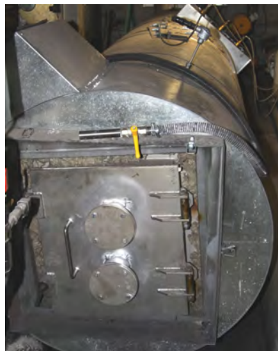
Bild 43: Abgasverdampfungskühler mit Rohgas-Probenahmestelle
