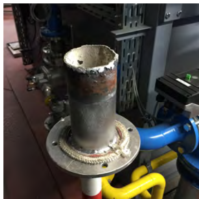
Bild 15: Lamdasonde mit korrodiertem Schutzrohr (Quelle: Incinea GmbH)
