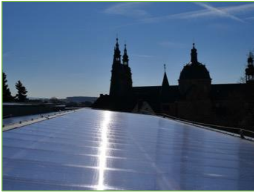
Abbildung 2 Links - Luftkollektoren auf den Dachflächen
