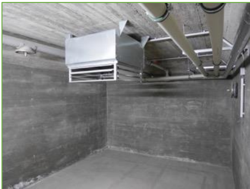
Abbildung 4 Luftheizgerät im Bunker
