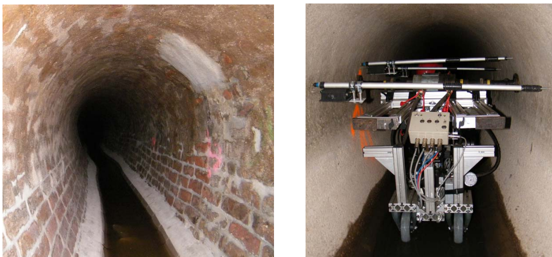
Bild 44 Fugensanierter Mauerwerkskanal mit Fliesensanierter Sohle (links) und Positionierung der MAC-Prüfeinrichtung im Betonabschnitt (rechts)
