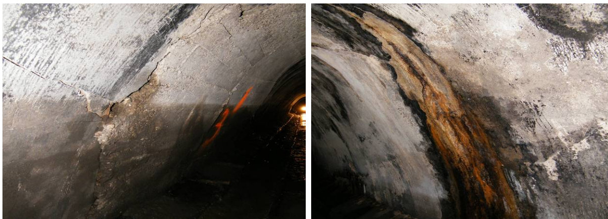
Bild 48 Typische Schadensbilder: Rissbildung (links) und Ablagerungen (rechts)
