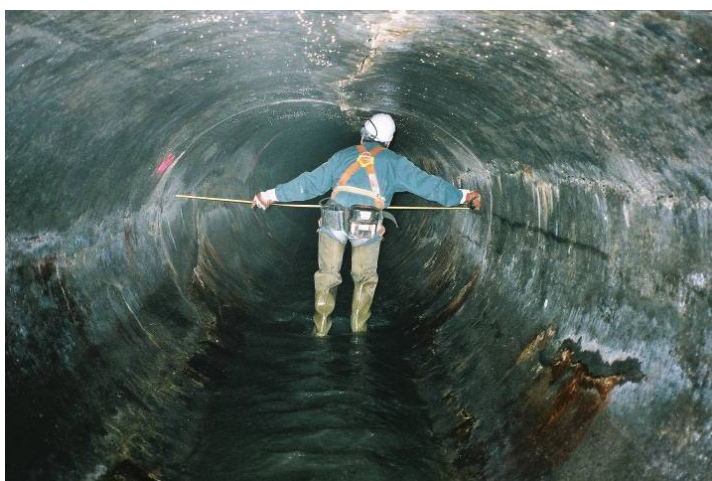
Bild 15 Betonsammler, wahrscheinlich Altrohrzustand III („fully deteriorated“)
