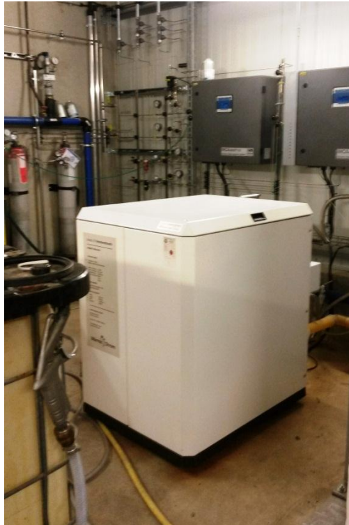
ABBILDUNG 24: iHKW IN DER BIOGASANLAGE IN EBENDORF
