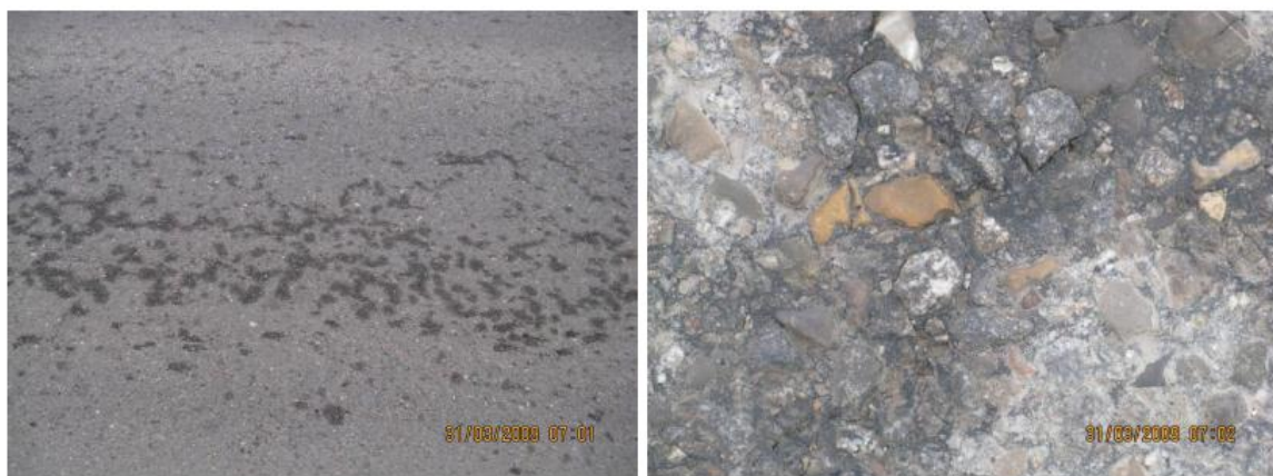
Abbildung 2-8: Dokumentation von „Salzflecken“ und die Auswaschung von Feinstpartikeln aus dem Fahrbahnmaterial als Folge der Salzstreuung [Lambert, 2010]
