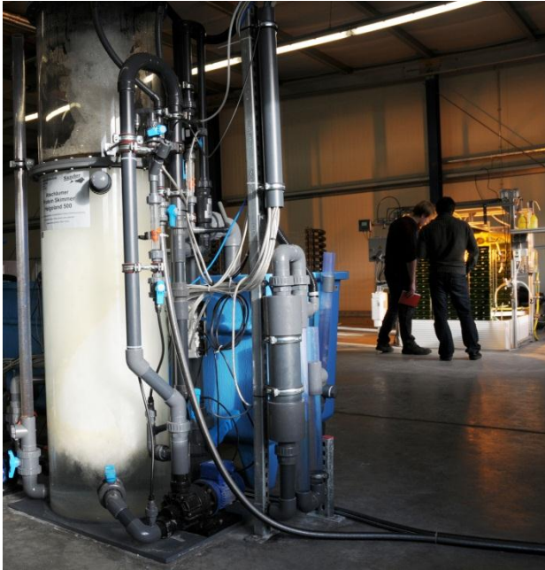
Abb. 3.1-3: Der Fluid-Kreislauf in der Forschungshalle Völklingen. Im Vordergrund der Abschäumer, im Hintergrund der SUBITEC Photobioreaktor.
