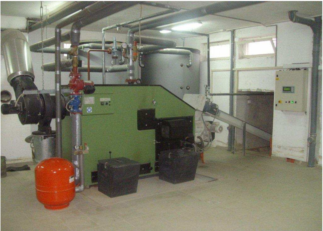
Abbildung 4: Hackschnittelkessel mit Pufferspeichern
