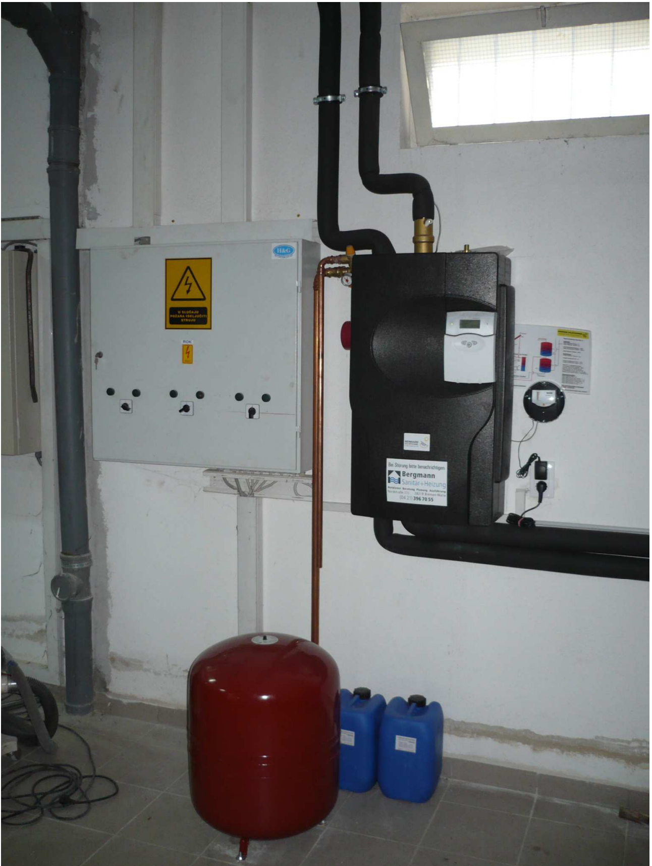
Abbildung 11: Solarstation mit Regelung
