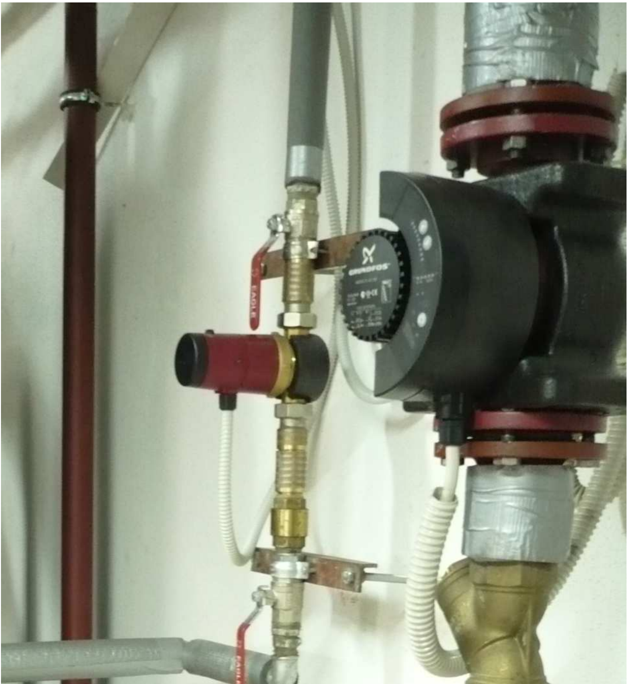
Abbildung 14: Speicherlade- und Zirkulationspumpe als Hocheffizienzpumpe (vor der Dämmung der Rohrleitungen)
