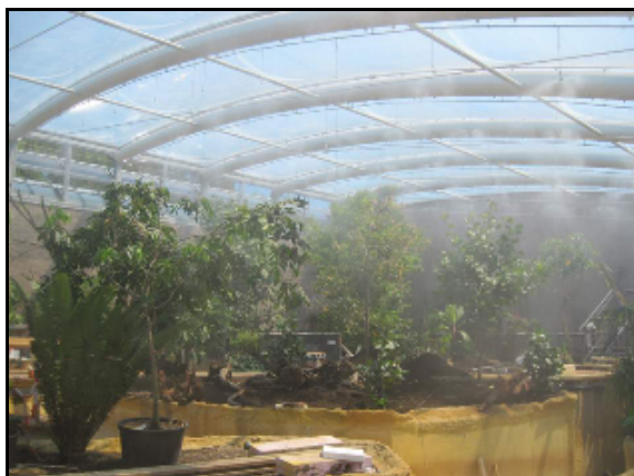
Bild 13: Beregnungs- bzw. Vernebelungsdüsen Manatihaus im Betrieb
