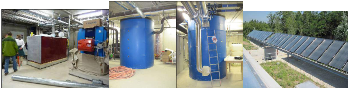
Bild 14-15: BHKW mit Pufferspeicher
