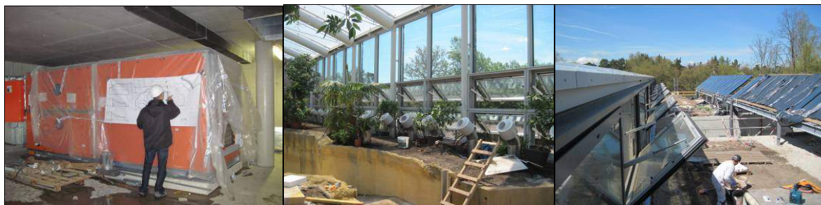
Bild 19: Lüftungsgerät Blauer Salon
