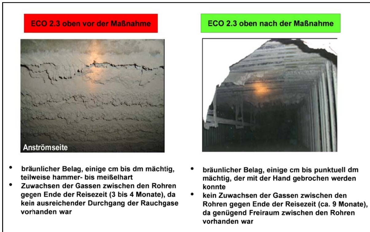
Abb. 258 Ausbildung der Beläge vor und nach den Umbaumaßnahmen: MHKW Mannheim, MK 4
