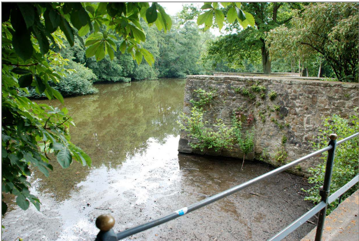
Abb. 3: Im Sockelbereich stark geschädigte Ufermauer neben der Zufahrtsbrücke zum Gut im Sommer 2008
