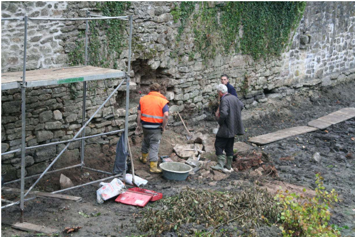
Abb. 14: Massive Schädigungen des Mauerwerks im Bereich der Wasserlinie und oberhalb davon nach Eindringen von Wurzeln von Schwarzerle und Sandbirke in ausgewitterte Fugen
