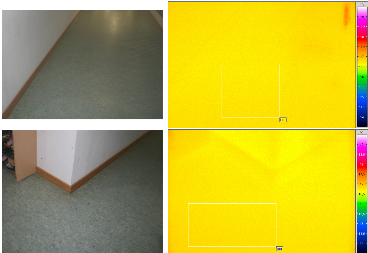
Abbildung 31: Thermographien der Fußbodenoberfläche im Flurbereich vor Raum 0.3 am 07. Januar 2008 mit den zugehörigen Fotos.
