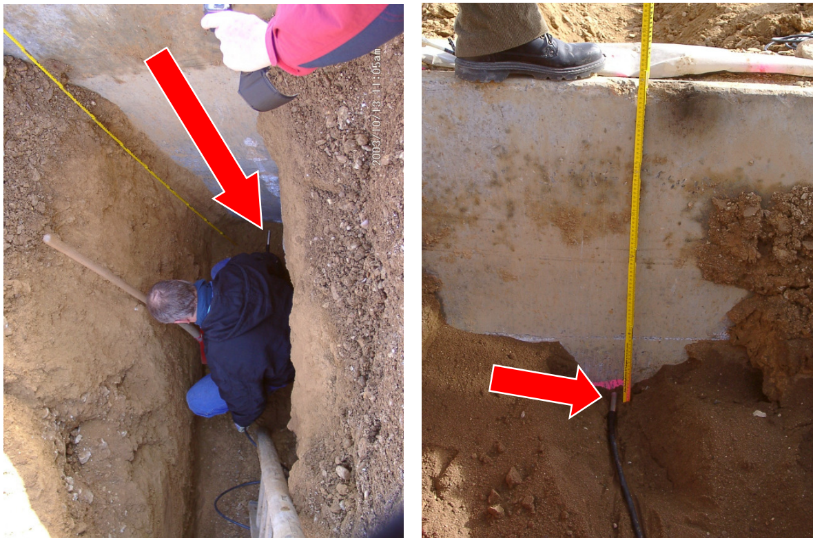
Abbildung 19: Montage der Erdreichtemperatursensoren 2003 (hier in Nähe der Dämmschürze) unter der späteren Bodenplatte in unterschiedlichen Tiefen.
