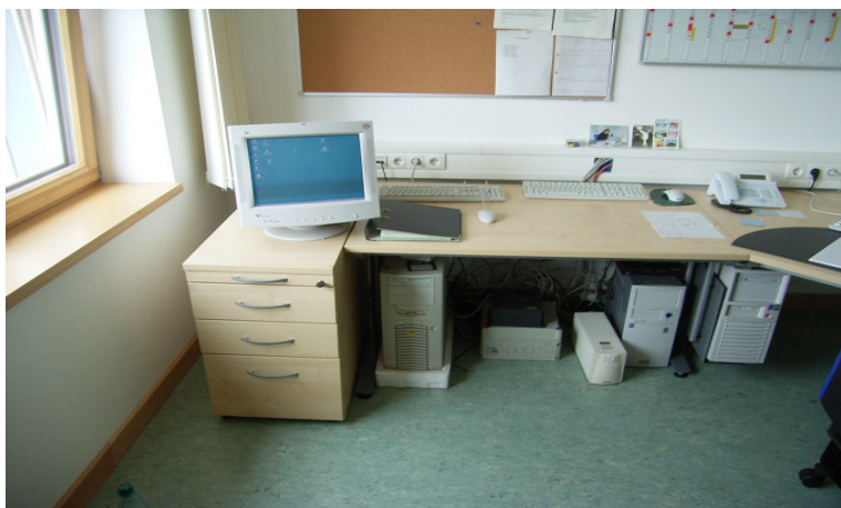
Abbildung 16: Zentraler Messrechner mit Bildschirm und Unterbrechungsfreier Stromversorgung (USV) im Büro des Schulhausverwalters (rechts unter dem Tisch: GLT-Rechner und PC des Schulhausverwalters).
