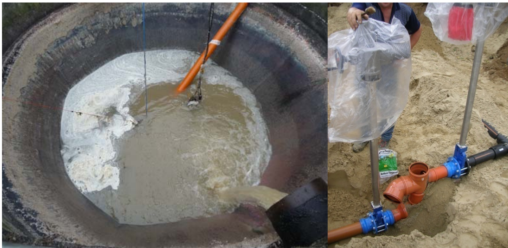
Bild 16 Offener Vorlagebehälter (a) und Beschickungseinheit (b) des Demonstrations- und Prüffeldes Altentreptow
