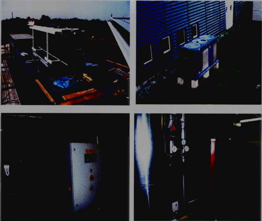
Bild 1: Ansicht auf Absorberkältemaschine (links unten), Blockheizkraftwerk (rechts unten), Rückkühler (links oben) und Kompressionskältemaschine (rechts oben)
