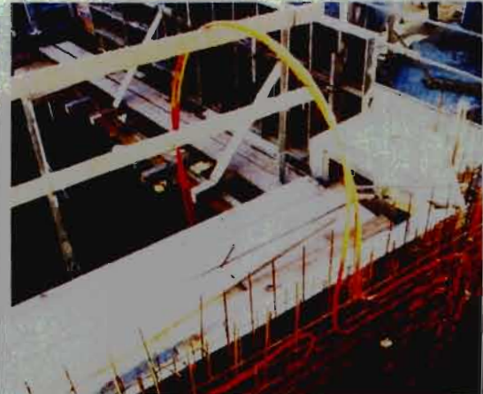
Bauteiltemperierung großes Aquarium, Rohrschlangen in der Bewahrung
