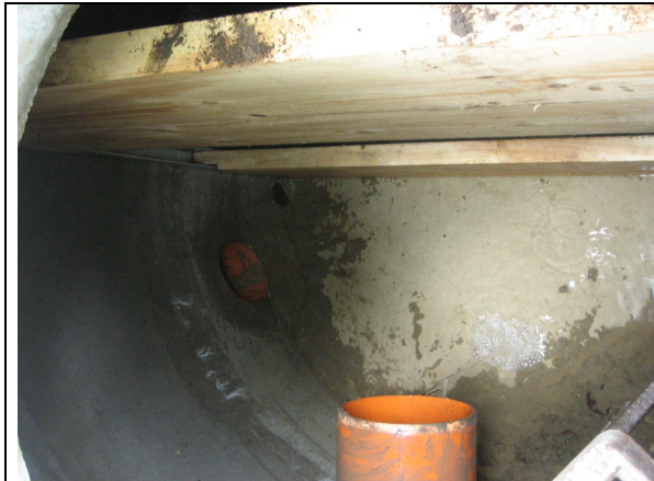
Sandfangschacht, damals noch mit provisorischer Trennwand (jetzt fest mit Gitterblech); unten der Zulauf, links der Reinigungsauslass
