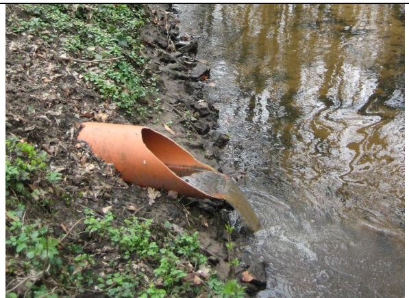
Auslass des Treibwassers, d.h. der Anteil des Wassers, der zum Beschleunigen und dann zum Schließen des Stoßventils benötigt wurde
