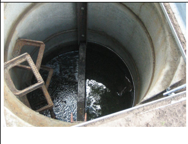
Trennschacht zwischen Schlangengräfte und Hausgräfte, letztlich durch Schieber ersetzt, da so besser handhabbar
