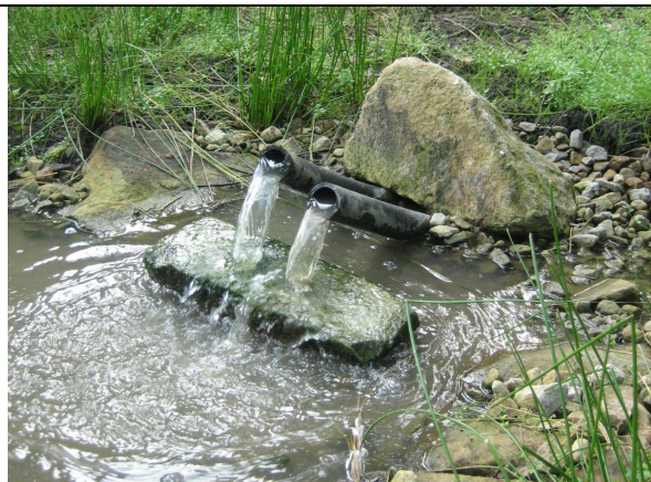
Auslass des gepumpten Wassers auf der Bleiche; der Windkessel trägt so viel zum Druckausgleich bei, dass hier ein gleichmäßiger Wasserfluss von je 0,0 bis 0,75 l/s erfolgt
