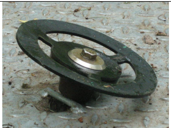
In allen Stegen erkennbar die beginnende Überdehnung; da die Überdehnung sich nicht zurückbildet, reißt dort die Dichtung
