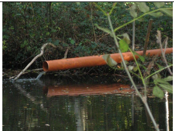
Ablauf der Spülfeldes in eine der Waldgräften
