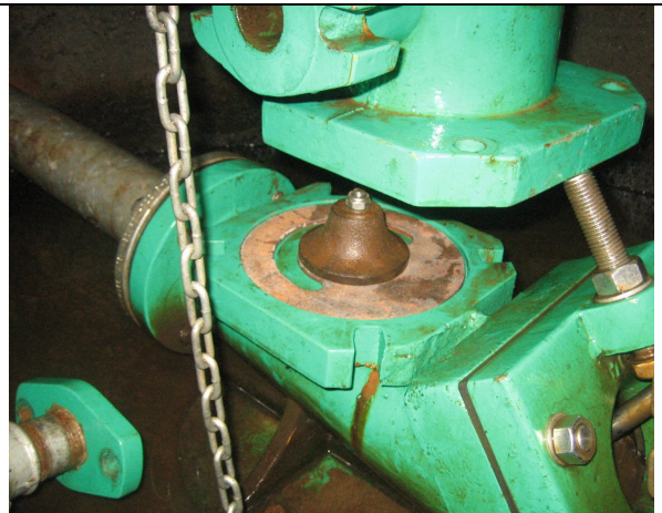
Lage der Hubdichtung über der Treibleitung und unter dem hier gehobenen Windkessel; links vorne die gelöste Druckleitung zur Bleiche, links hinten der Druckzulauf vom Sandfang und Gauxbach
