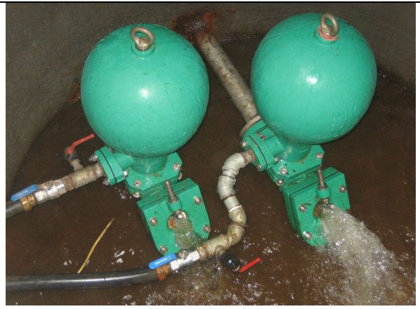
Widder in Betrieb, links die Druckleitungen zur Bleiche, oben die Zuleitung aus dem Sandfang; gut erkennbar die Windkessel zum Druckausgleich
