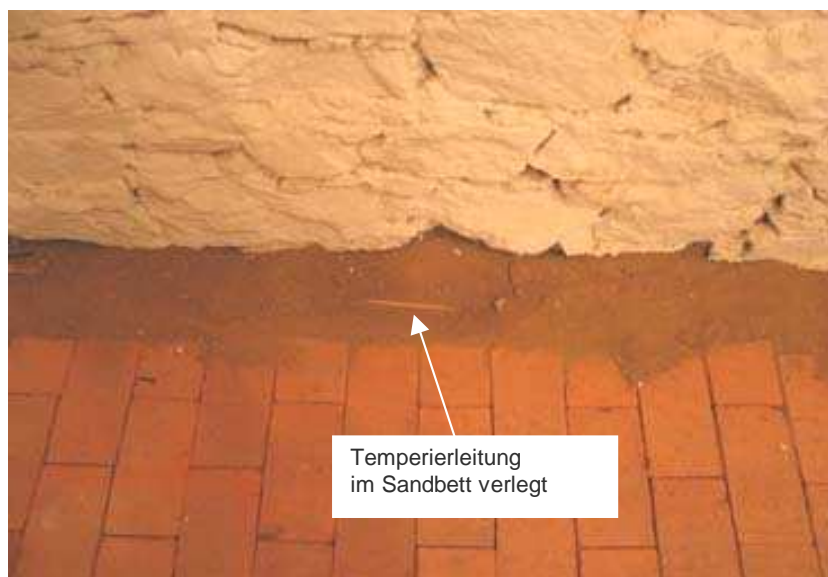
Bild 7.3.3-2: Temperierleitung im Referenzkeller
