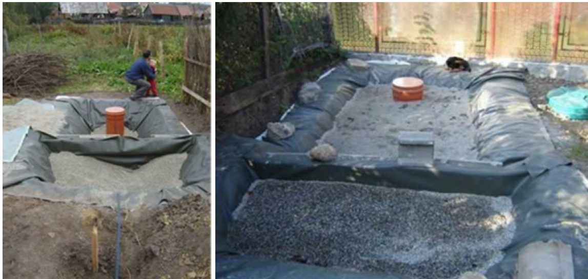
Abbildung 12: Im Bau befindliche PkaGW der Standorte Cotaru in Hosman (links) und Maior in Fofeldea (rechts)
