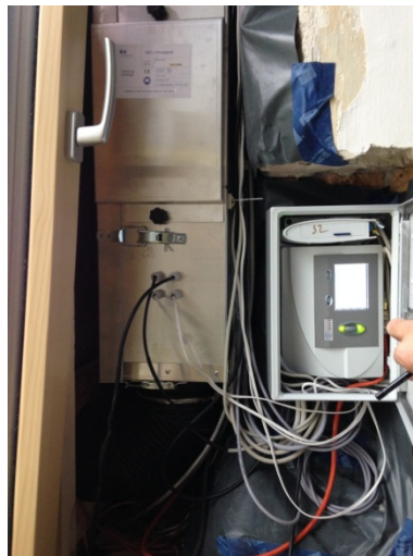
Bild 2: Anordnung der Messwertaufzeichnung und Steuerung in der Fensterlaibung
