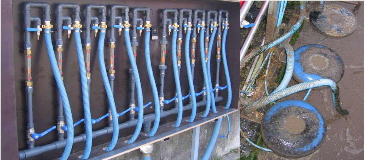
Abbildung 15: Versuchsstand A und dort eingebaute Tellerbelüfter
