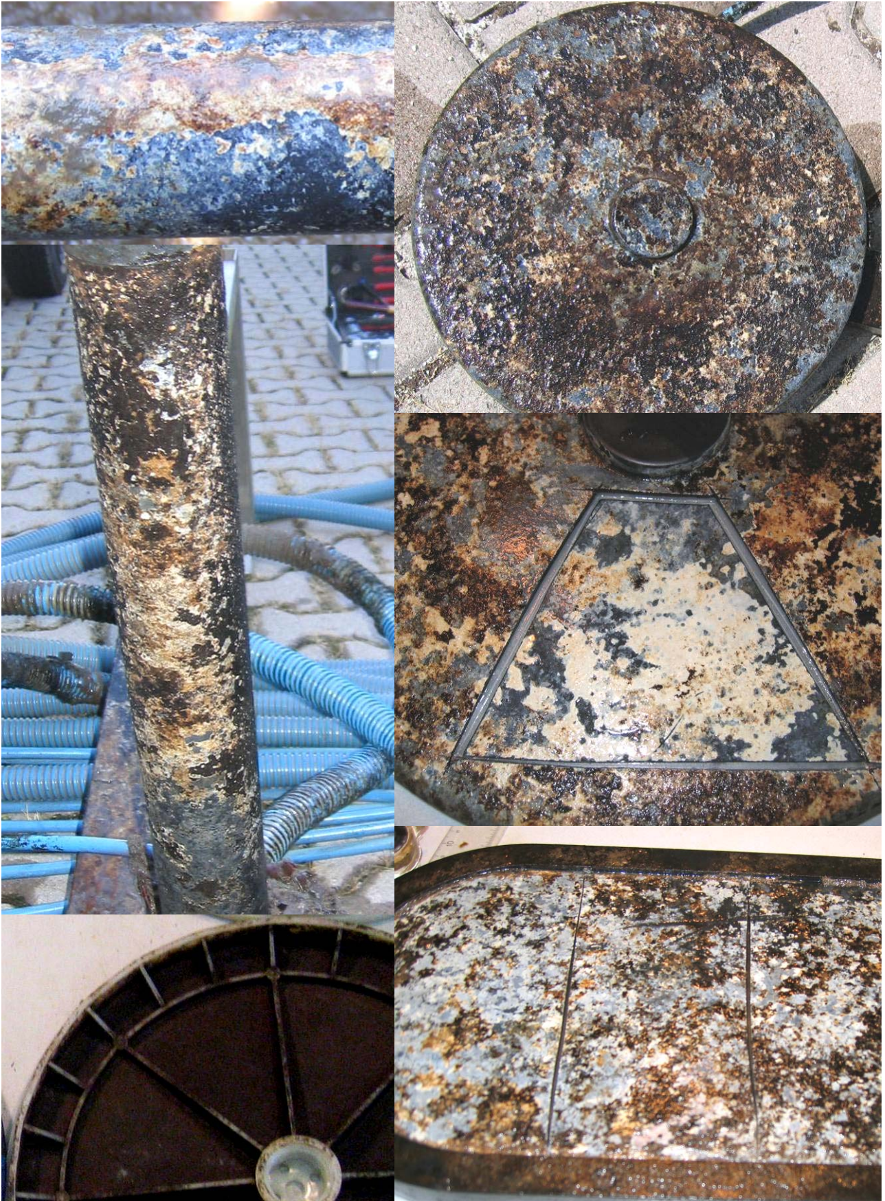
Abbildung 63: Beläge auf EPDM-Belüftungsmembranen und auf der Unterseite eines Stützkörpers
