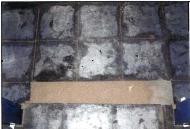
Bild 32: Verspachtelte Fugen und Fehlstellen
