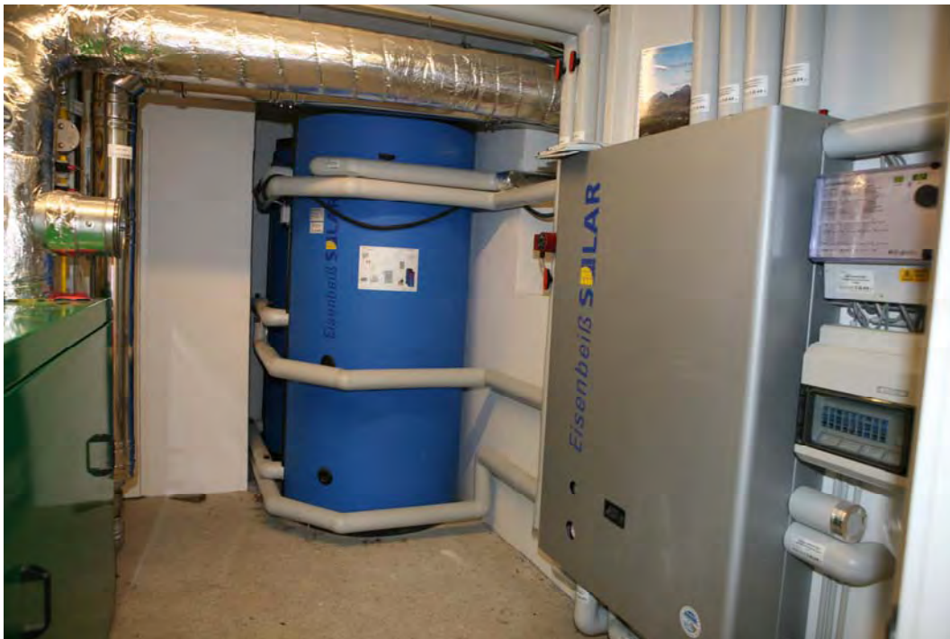
Bild 33 – OMH Schichtspeicher mit Verteiler - TD
