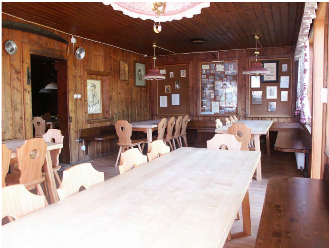
Bild 29 – OMH Gastraum mit Heizung (Notkühlung) unter den Bänken - TD
