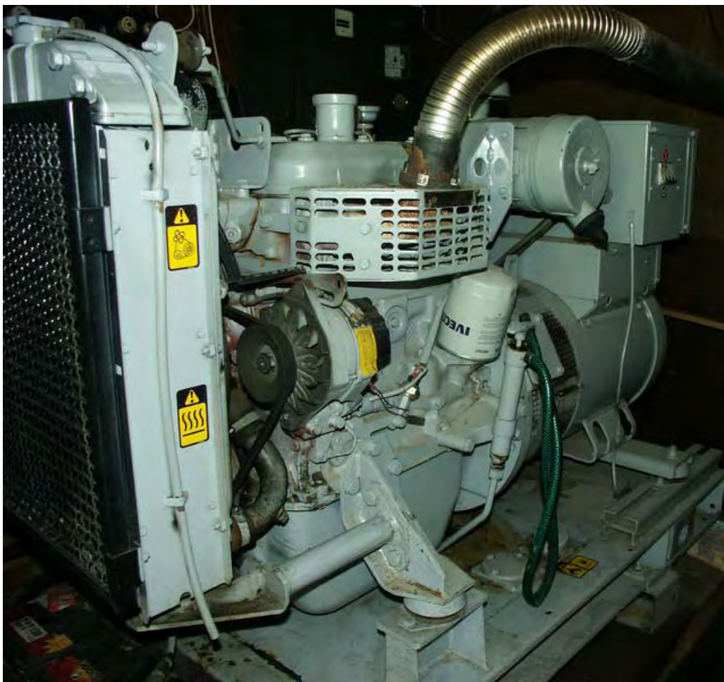
Bild 14 – altes Dieselaggregat auf der OMH - TD
