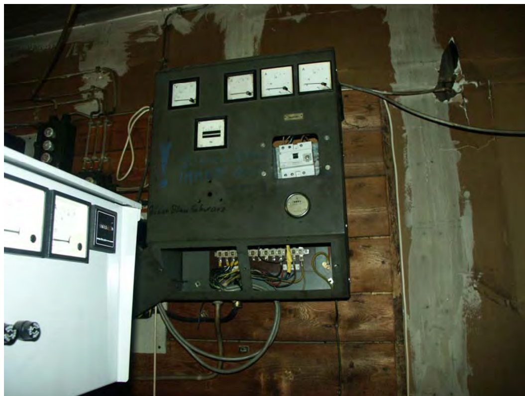
Bild 16 – alte Diesel Motorsteuerung - TD
