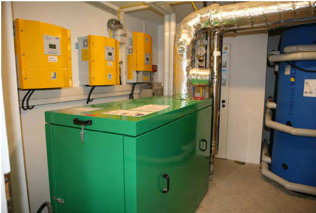
Bild 32 – OMH BHKW und Sunny Islands - TD
