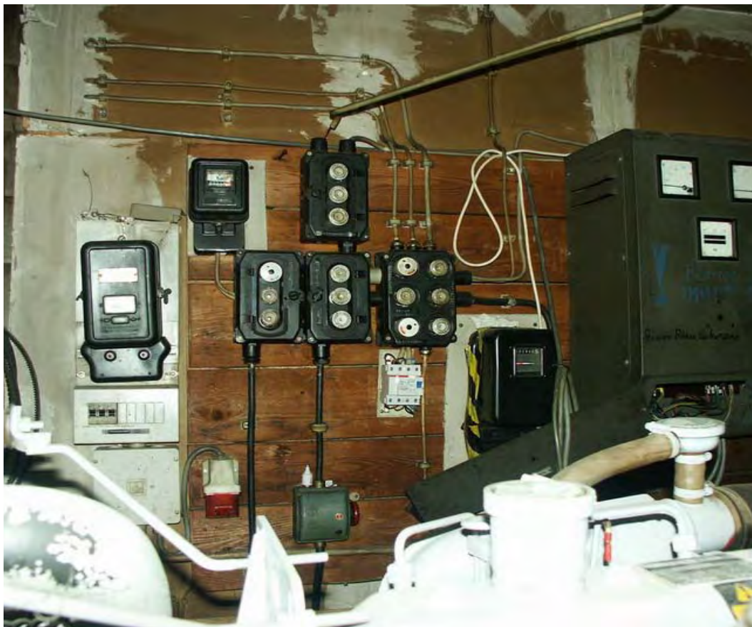
Bild 15 – alte Sicherungen - TD
