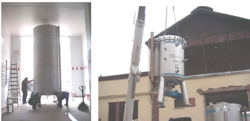
Abb. 16: Aufstellung und Einbindung der Filterlinie in die Brauerei
