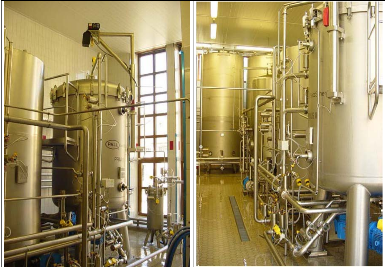
Abb. 3: Filterlinie mit dem Kieselgurfilter ZHF Primus III für regenerierbare Filterhilfsmittel und dem Stapeldosiertank in der Altenburger Brauerei
