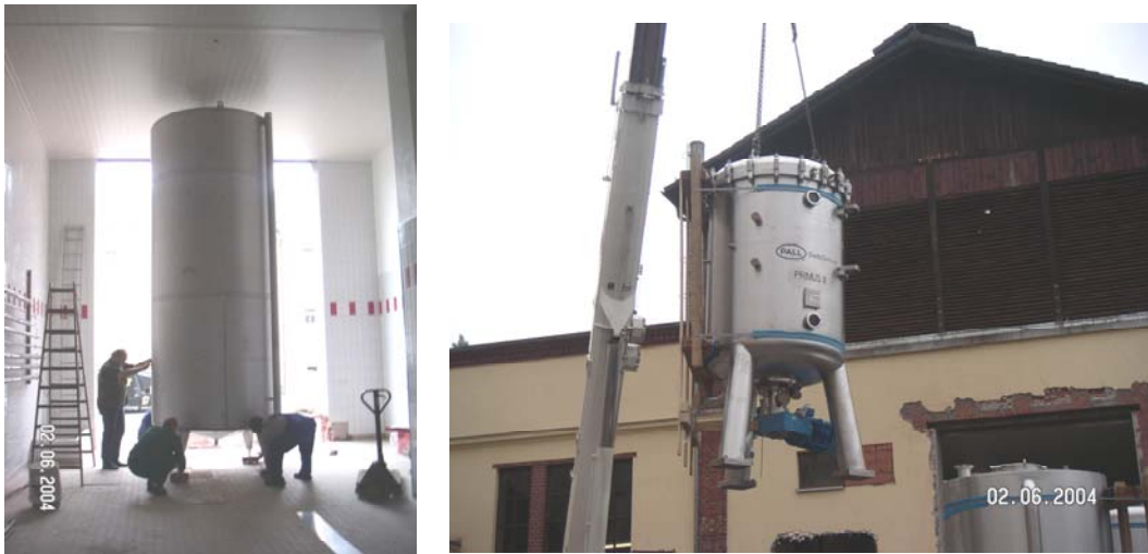
Abb. 1: Aufstellung und Einbindung der Filterlinie in der Altenburger Brauerei
