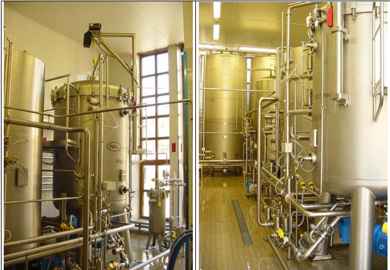
Abb. 17: Filterlinie mit dem Kieselgurfilter ZHF Primus III für regenerierbare Filterhilfsmittel und dem Stapeldosiertank in der Altenburger Brauerei
