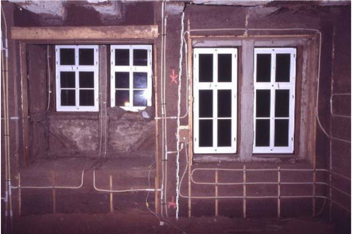
Abbildung 13 Beispiel für Rohrverlegung auf der Wand, Raum 0.4
