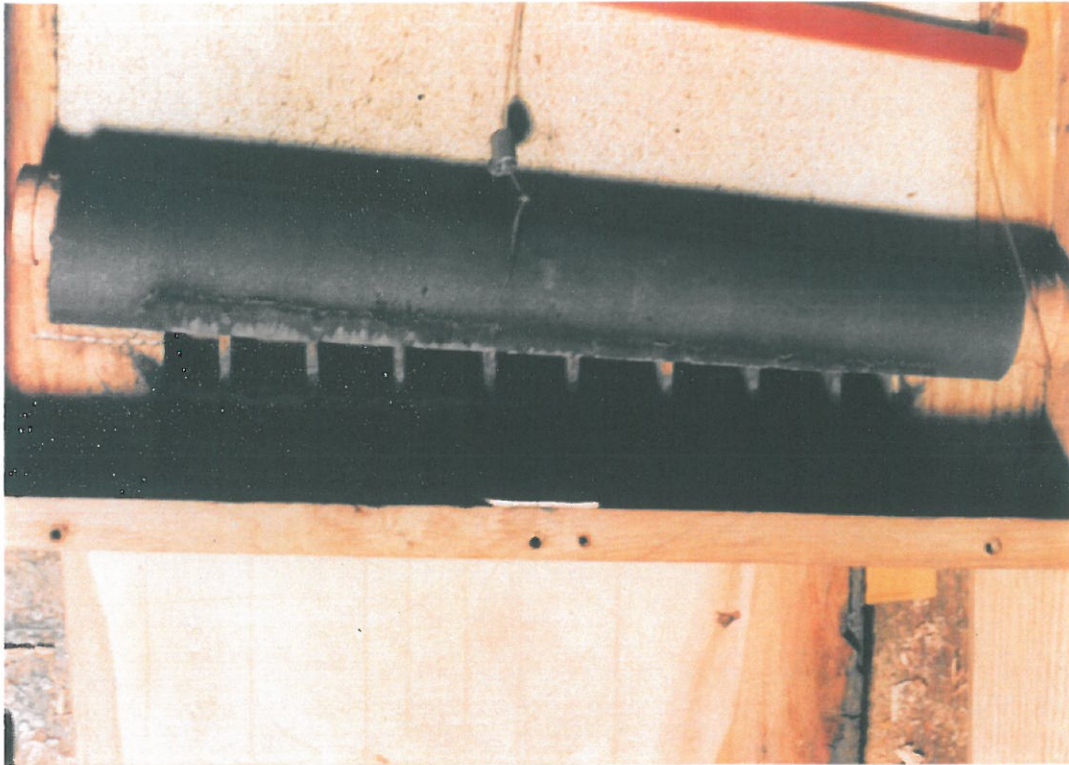
409.9 Angebackener, schwarzer Staub in einem Rollventil zur Winddruckregulierung
