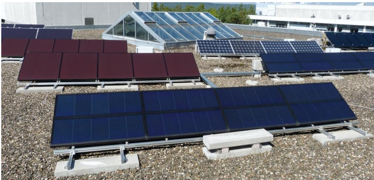
Abbildung 1: Die installierten Module auf dem Dach der Universität Erlangen. Im Vordergrund sind die Dreifachzellen, dahinter a-Si, dahinter a-Si- \mu c-Si zu erkennen. Die kristallinen Module befinden sich im mittleren Teil, während rechts hinten die CIGS-Module zu erkennen sind.
