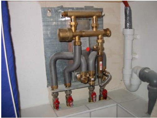
Warmwasserbereiter: wohnungsweiser Einbau
